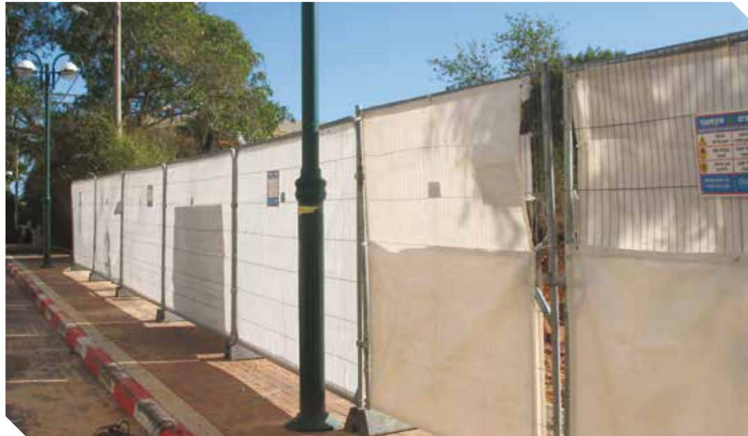
גדר זמנית מעוגלת עם מסך הסתרה + שער רכב אתר בנייה רמת השרון
