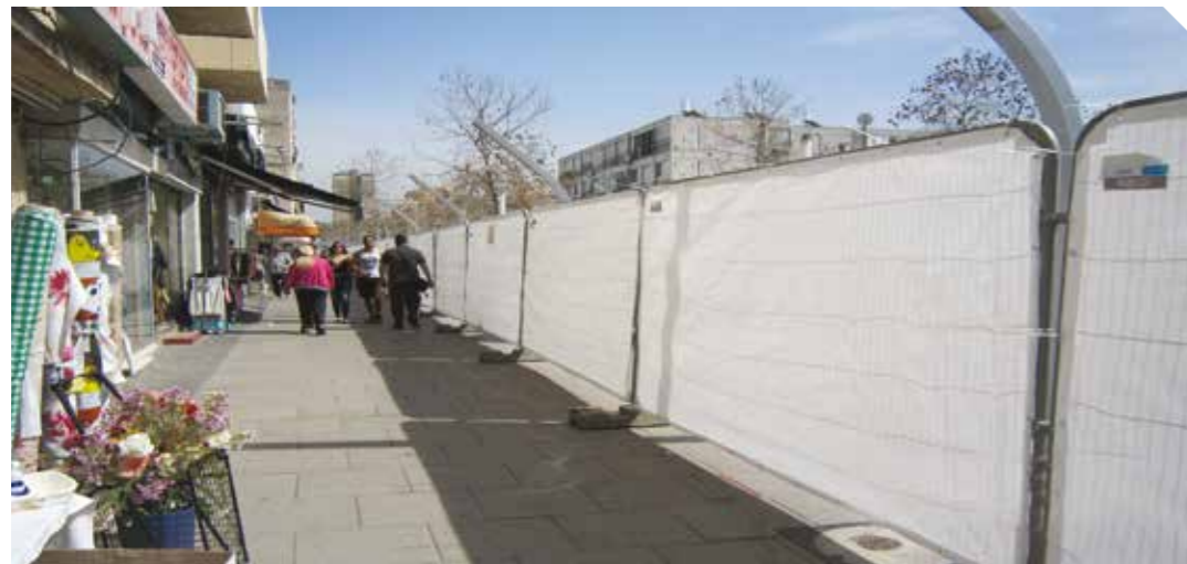
גדר זמנית מעוגלת עם מסך הסתרה לבן איכותי. אתר עבודה לב העיר הרצליה
