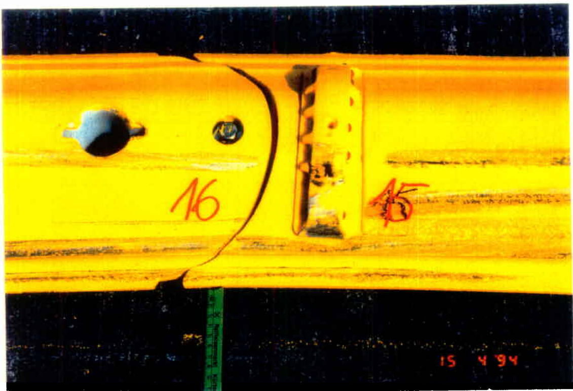
Bild 38: Beanspruchungsspuren der Leitschwelle nach Überfahrt mit Bremsung
